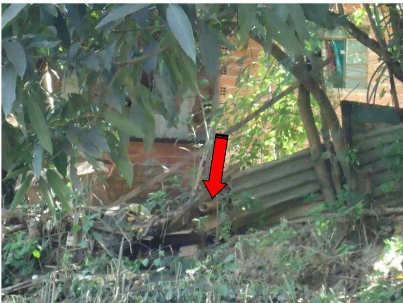
Figura 12 – Lançamento de esgoto a céu aberto
