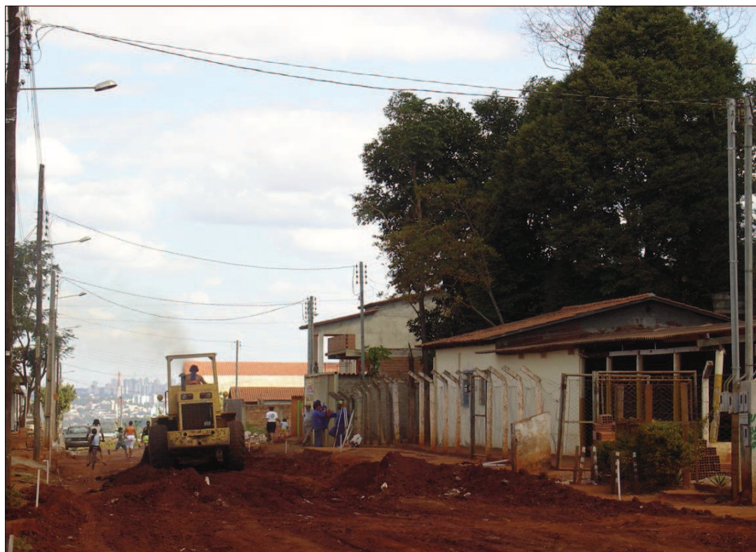
Figura 8: Terraplanagem mecanizada para implementação do asfalto no Residencial Vale dos Sonhos. Fonte: Ferraz Pinheiro (2006)
