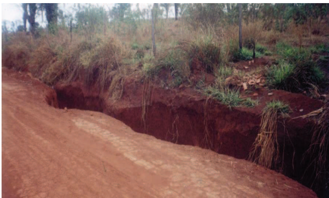
Figura 6: Aspecto de rua com formação de erosão. Fonte: Freitas (2002).
