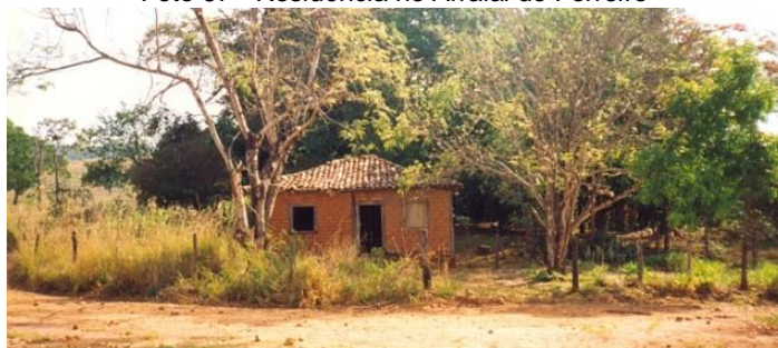
Uma residência em Ferreiro – fachada principal. Construção usando adobe, casa no centro do lote - 1994. Foto da autora
