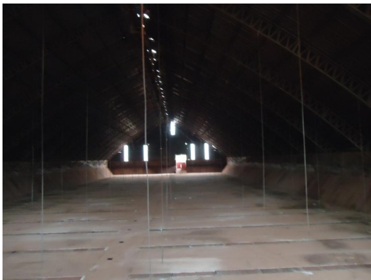
Figura 16 - Vista interna do armazém graneleiro e cabos do sistema de termometria
