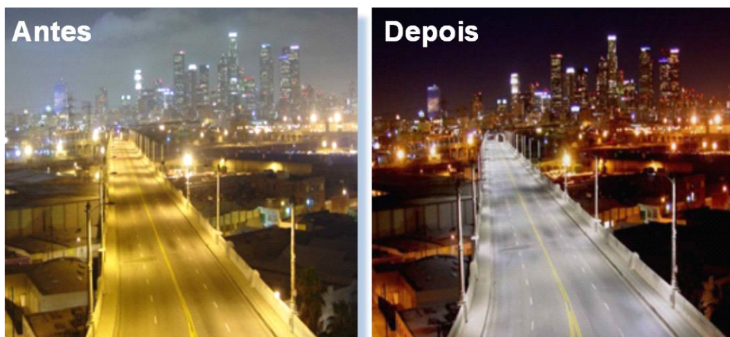
Figura 10: Comparativo antes e depois do uso do LED na iluminação pública (6th Street Bridge Over the Los Angeles River).
