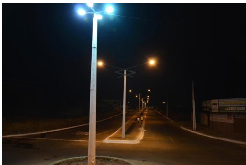
Figura 28: LED instalado em Caldas Novas, Goiás.
