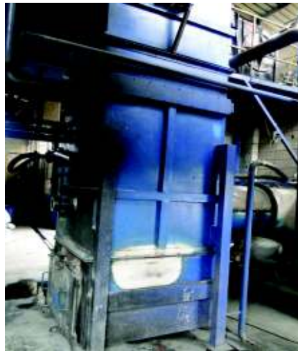
FIGURA 20 - Incineradores de RSS
