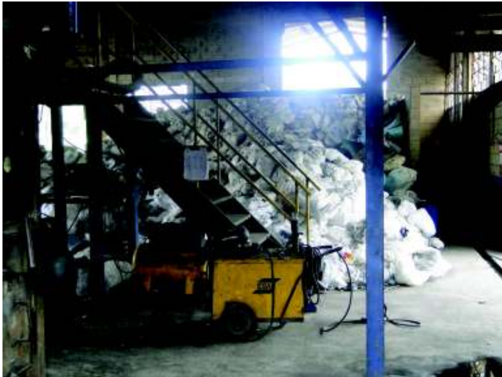
FIGURA 10 - RSS na Estação de Tratamento do Aterro Sanitário de Goiânia
