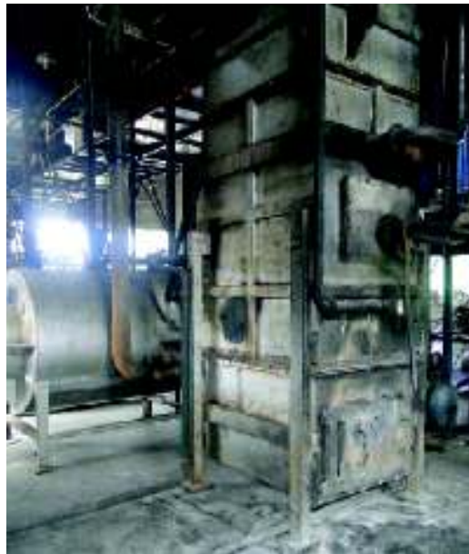
FIGURA 9 - Incineradores de RSS no Aterro Sanitário de Goiânia
