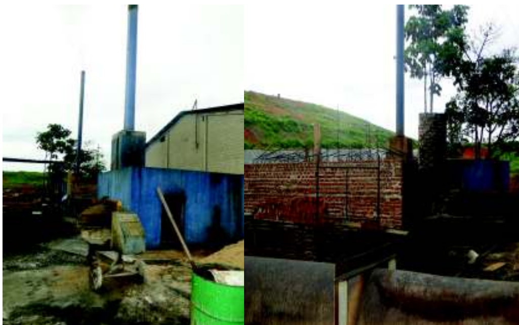
FIGURA 19 - Reestruturação do sistema de limpeza de gases
