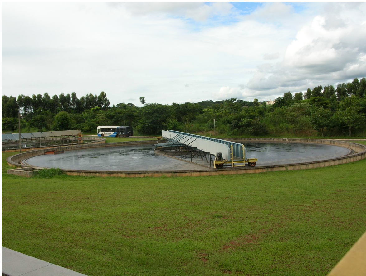
Figura 4. Decantadores Primários: Diâmetro: 42 m, 3 unidades.
