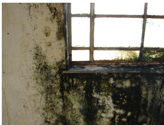
Figura 162. Degradação interna do edifício tombado.
