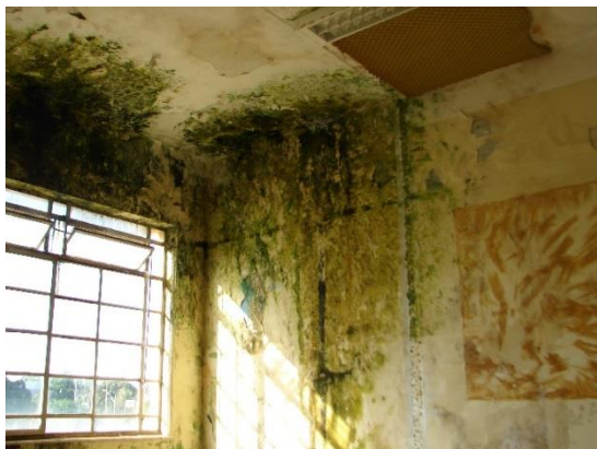
Figura 161. Degradação interna do edifício tombado.
