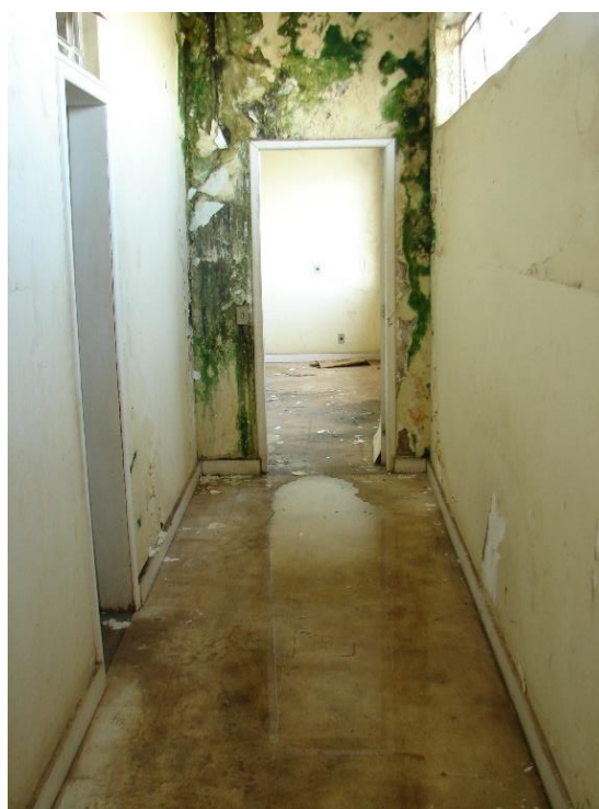
Figura 164. Degradação interna do edifício tombado.
