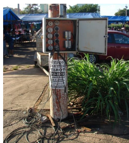
Figura 156. Falta de infraestrutura local.
