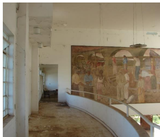
Figura 160. Degradação interna do edifício tombado.
