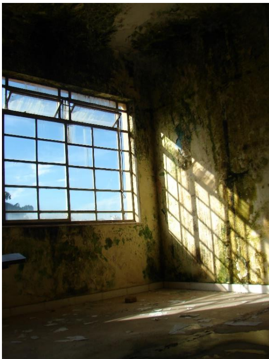
Figura 163. Degradação interna do edifício tombado.
