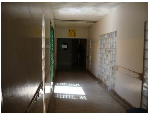
Figura 10- Falta de manutenção: corredor.
