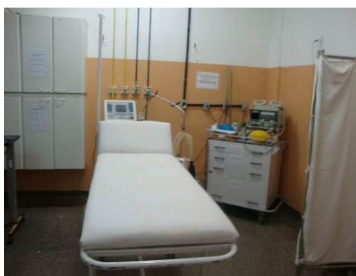
Figura 4 - Dimensionamento insuficiente: sala de atendimento de emergência.
