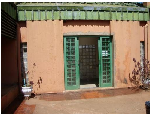
Figura 9- Falta de manutenção: pátio.
