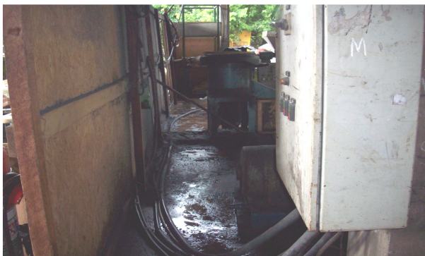
Figura 7 – Risco de acidente em virtude da fiação exposta em chão molhado sujeita a goteiras (13 jan. 2010)
