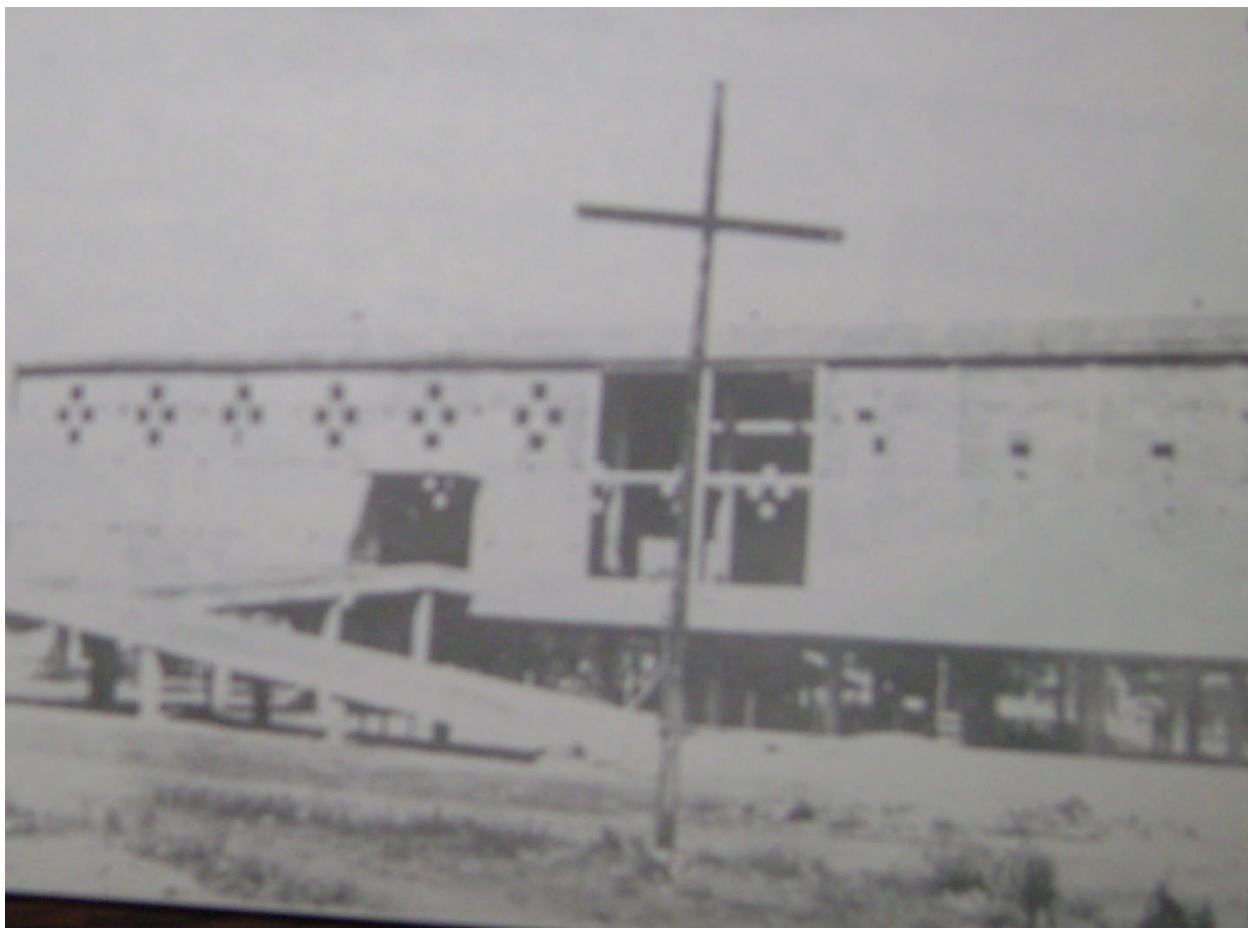
Figura 03: Fotografia da Igreja São Judas Tadeu em construção, localizada no Setor Coimbra em Goiânia.
