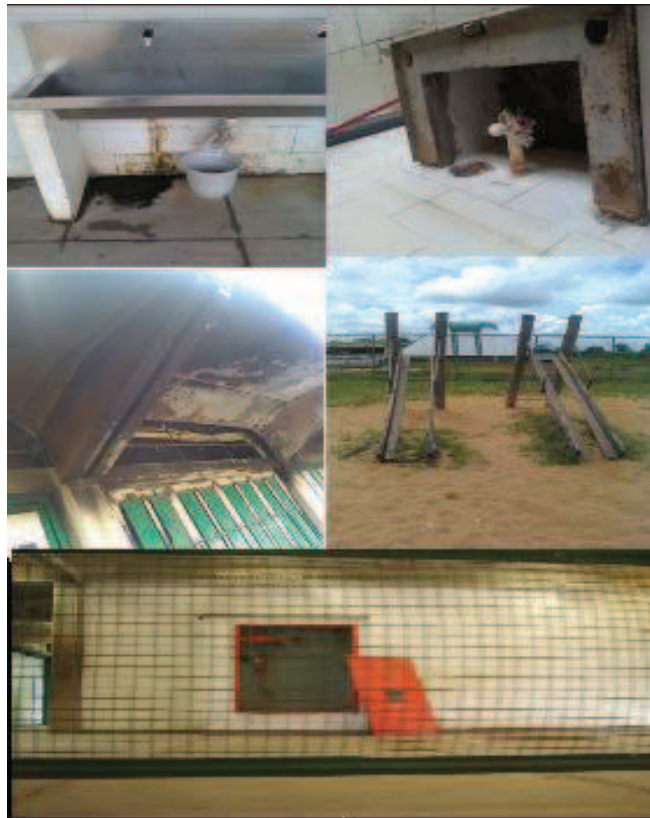
Figura 1 - Escola Estadual Caic Darcy Ribeiro, sucateamento das áreas comuns de utilização dos alunos. Fonte: Fotos feitas pela autora.
