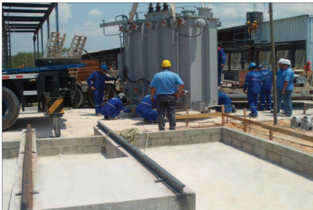
Figura 6 - Desembarque de transformador de força no local de aplicação. Fonte: Arquivo de documentação da Tecmon / obra Manaus. 2010.
