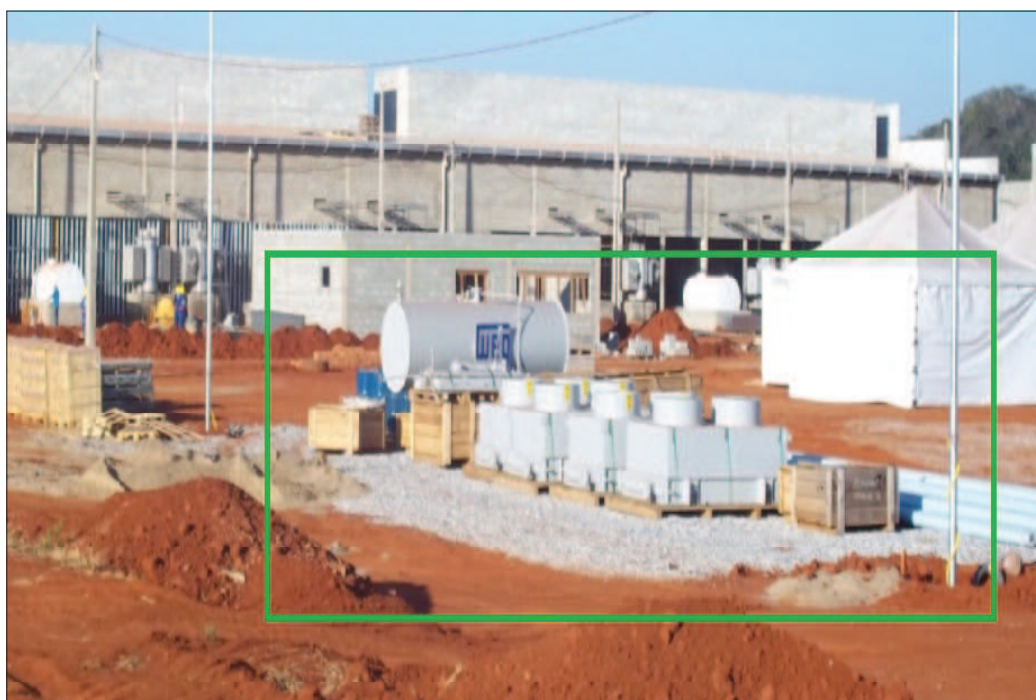
Figura 20 - Almoxarifados específicos e transitórios da obra. (Partes do Transformador Principal).
