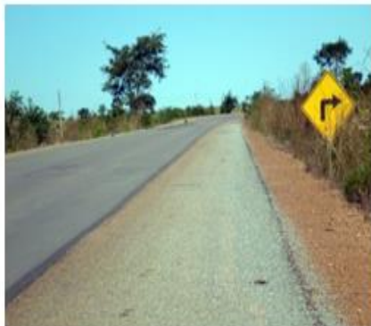
Figura 9 - BR 158 falta de pintura e placas cobertas com vegetação
