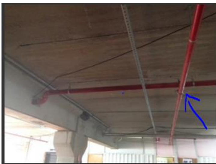
Figura 70 - Tubulação executada em cota diferente da prevista em projeto
