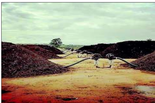
Figura 6 – Compostagem em Leiras forçada
