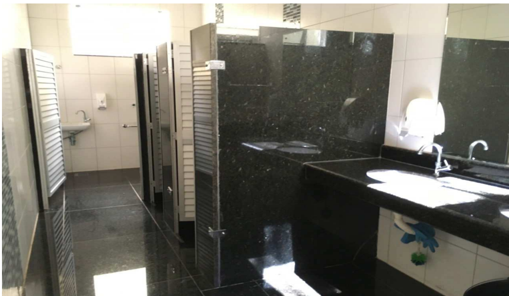
Figura 15 – Sanitário inadequado no Fórum de Corumbá
