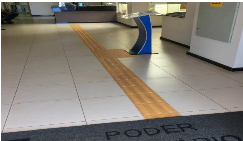
Figura 10 – Forração sobre o piso tátil na entrada do Fórum de Corumbá
