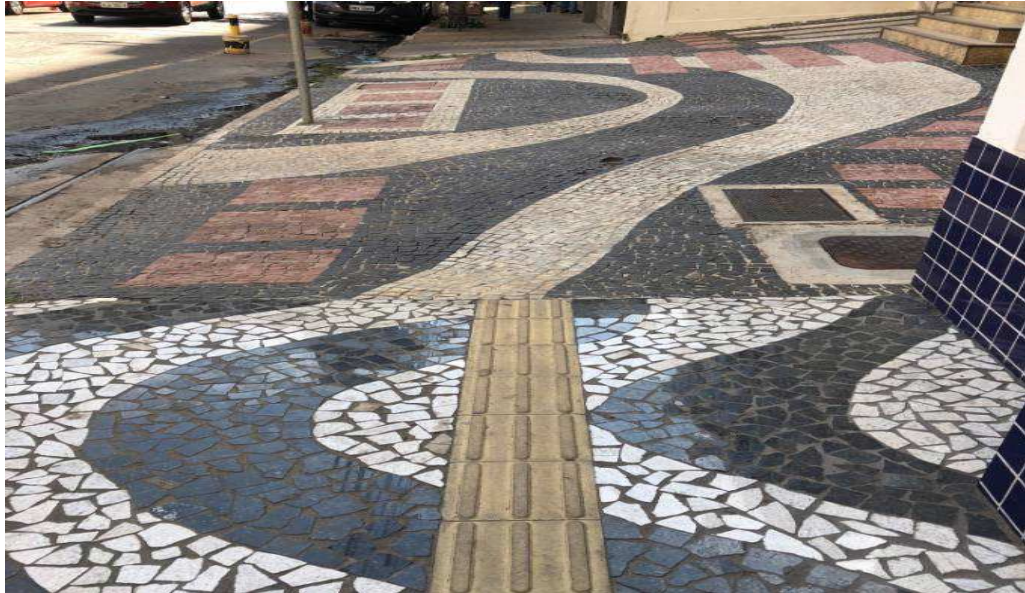
Figura 16 – Calçada inacessível no Anexo I do TJGO, Goiânia
