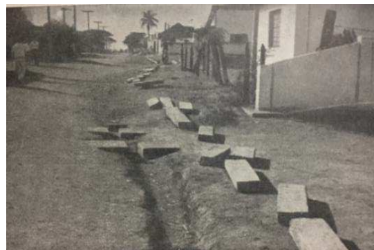
Figura 84- Colocação de meio fio preparando para o asfalto da Avenida Matogrosso. Campinas em 1963. Fonte: BRITO, 1965.
