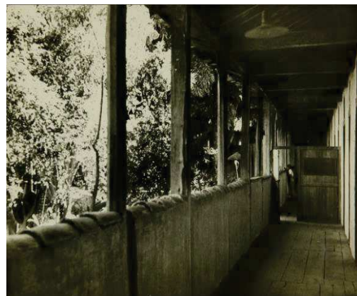
Figura 11- Corredor externo do seminário dos redentoristas em Campinas, 1895. Fonte: IPHAN –Fotos de E. Jacinto, em 1949.
