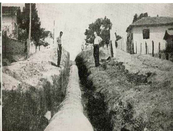
Figura 80 – Implantação da rede de águas pluviais na rua Senador Moraes Filho. Fonte: BRITO, 1966.
