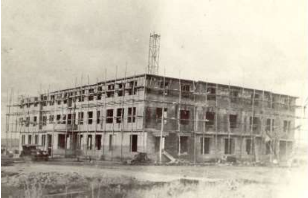
Figura 14: Grande Hotel em construção no ano de 1935, ainda sob a administração de Atílio Corrêa Lima. Fonte: Acervo Prefeitura de Goiânia, 2018.
