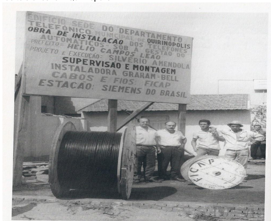
Foto 04 Placa e cabos telefônicos alusivos à instalação da rede municipal de telefones em Quirinópolis
