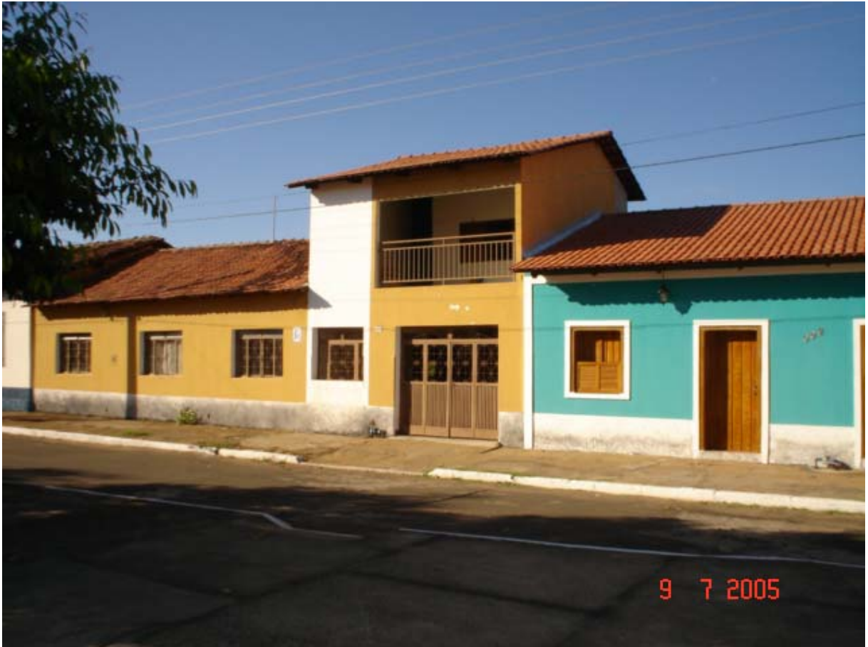
Figura 12: Dilapidação de parte do centro histórico de Porto Nacional
