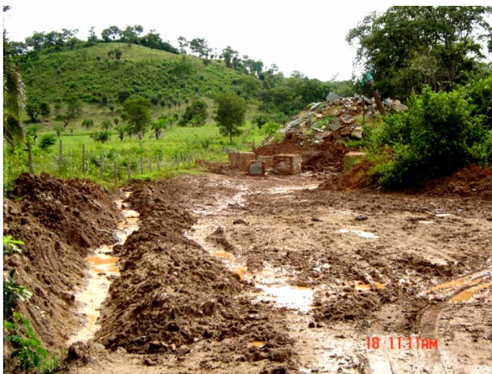
Figura 37. Data 18/04/2006. Destaque para a entrada da gleba 136 com enxurrada em direção ao córrego. Foto: Daniela Almeida Oliveira.
