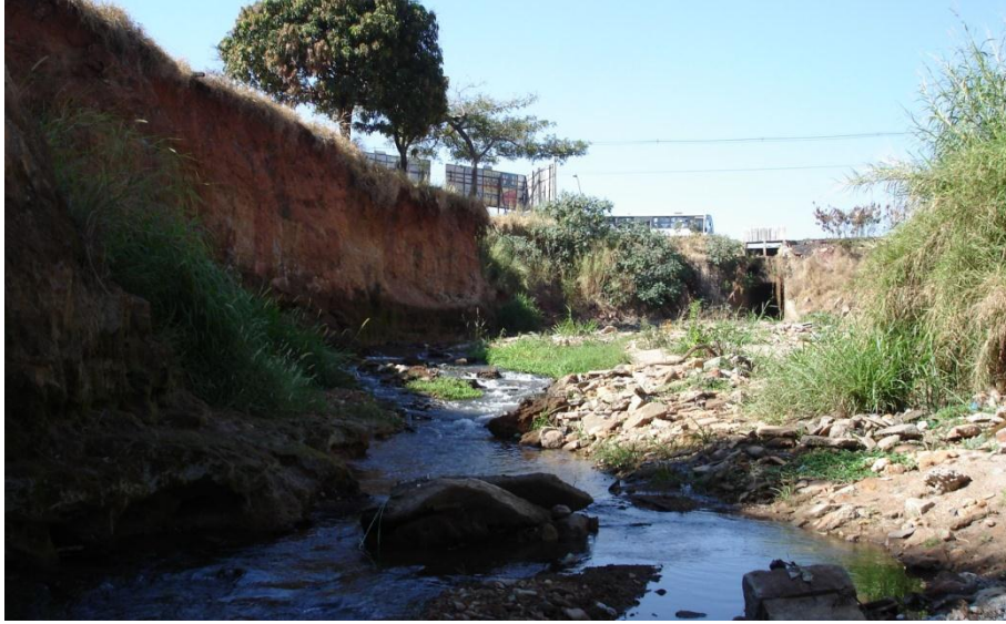
Figura 30- Processos de erosão - Avenida Milão Fonte: QUEIROGA, Apresentação AMMA, 2011.
