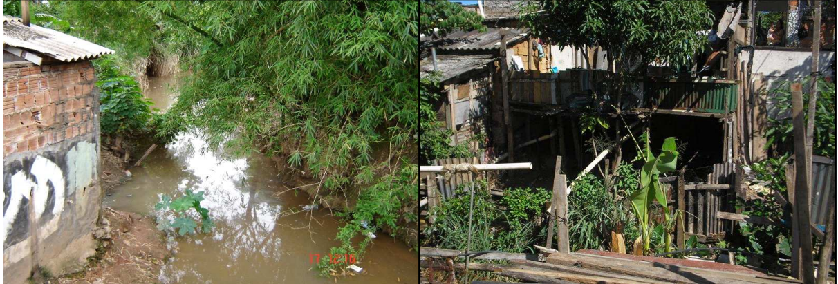
Figura 22 - Precariedade das edificações/proximidade com a água (esquerda) e Precariedade das edificações (direita) Foto: SEPLAM/DPFT/Assessoria Técnica de Regularização Urbana
