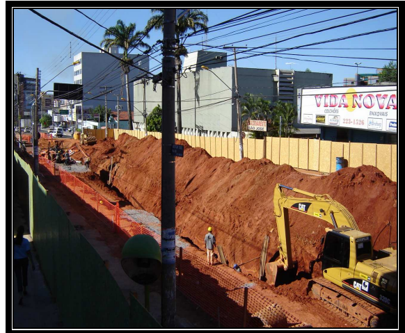
Figura 36 Obras da execução do viaduto da Praça Lafit Sebba – Praça do Ratinho Foto: Autor
