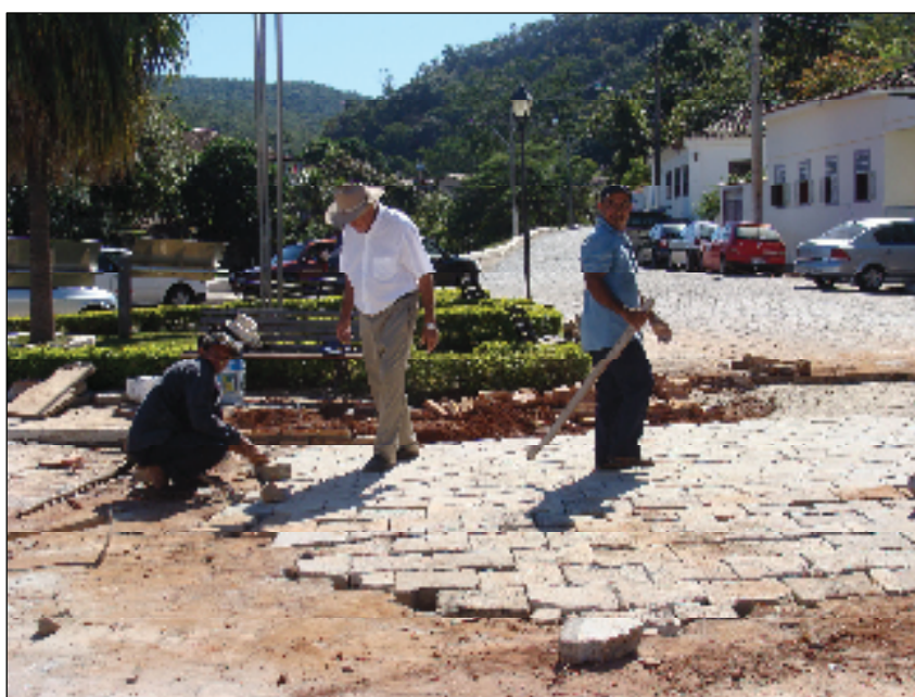
Figura 14 - Problemas nas ruas do centro Histórico, devido ao excesso de carga. Fonte: Mendonça, 2009.
