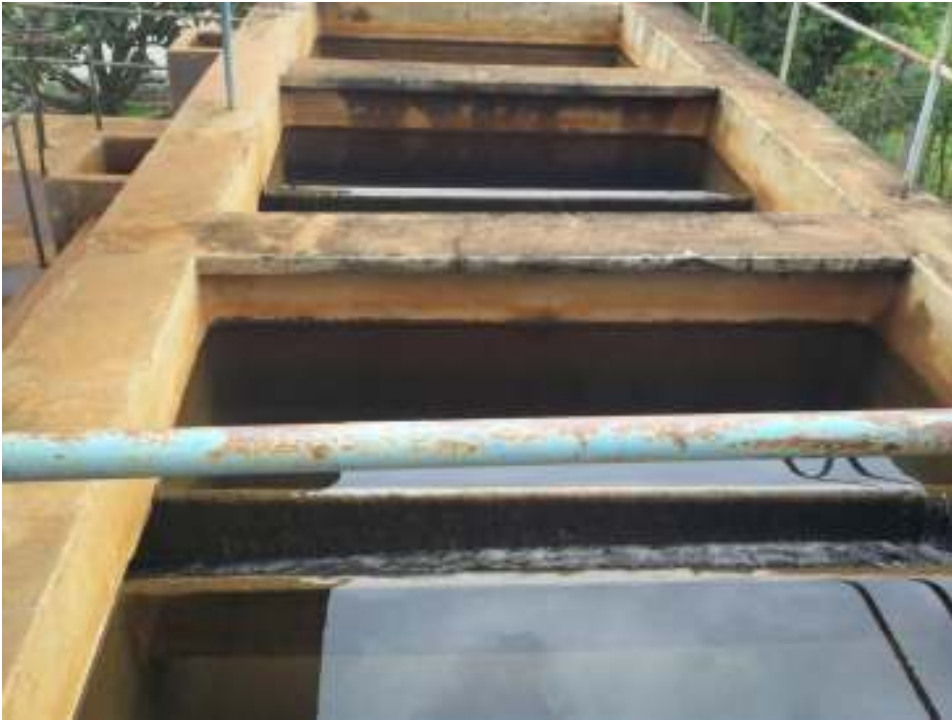
Figura 11. ETA – Estação de Tratamento de Água – município de Rio Verde
