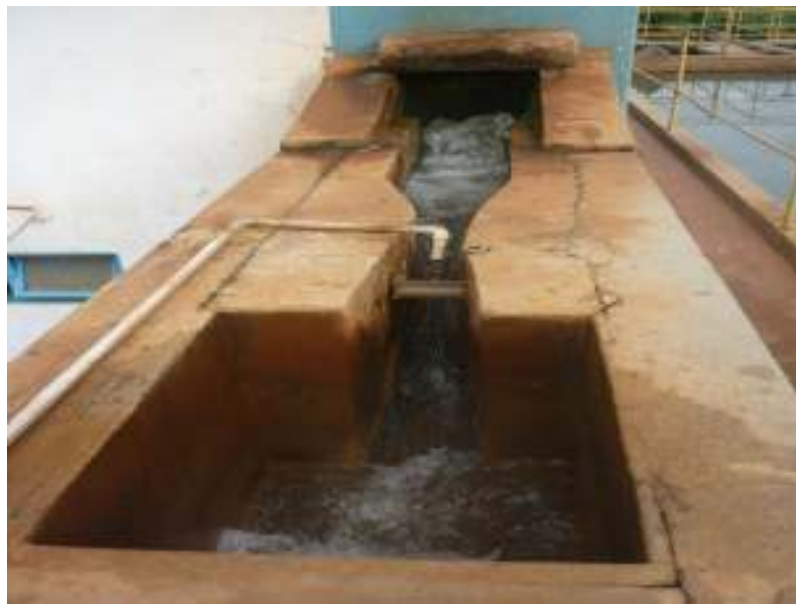
Figura 3. Calha Parshall – parte constituinte do sistema de tratamento de água onde é realizada a mistura rápida dos produtos químicos com a água.
