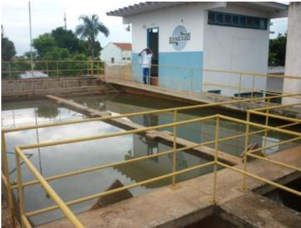
Figura 8. ETA – Estação de Tratamento de Água – município de Acreúna
