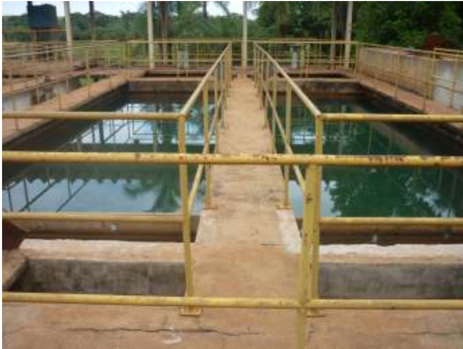
Figura 9. ETA – Estação de Tratamento de Água – município de Maurilândia
