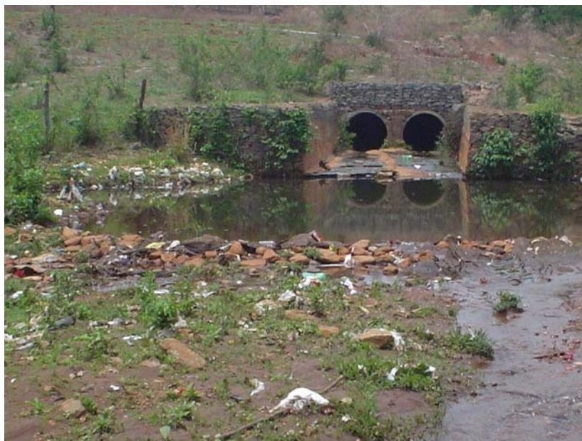
Foto 3 – Presença de lançamentos de esgotos no ribeirão Anicuns.
