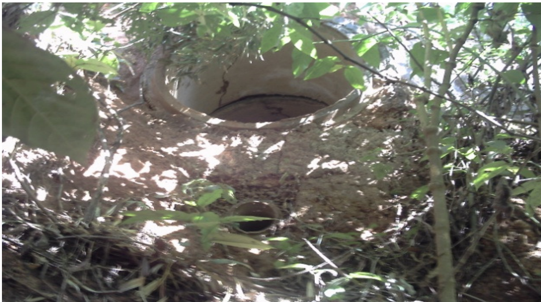
Figura 19. Parque Areião – Goiânia – GO. Galeria pluvial situada próximo a nascente principal. Fonte: Cardoso, 2009.
