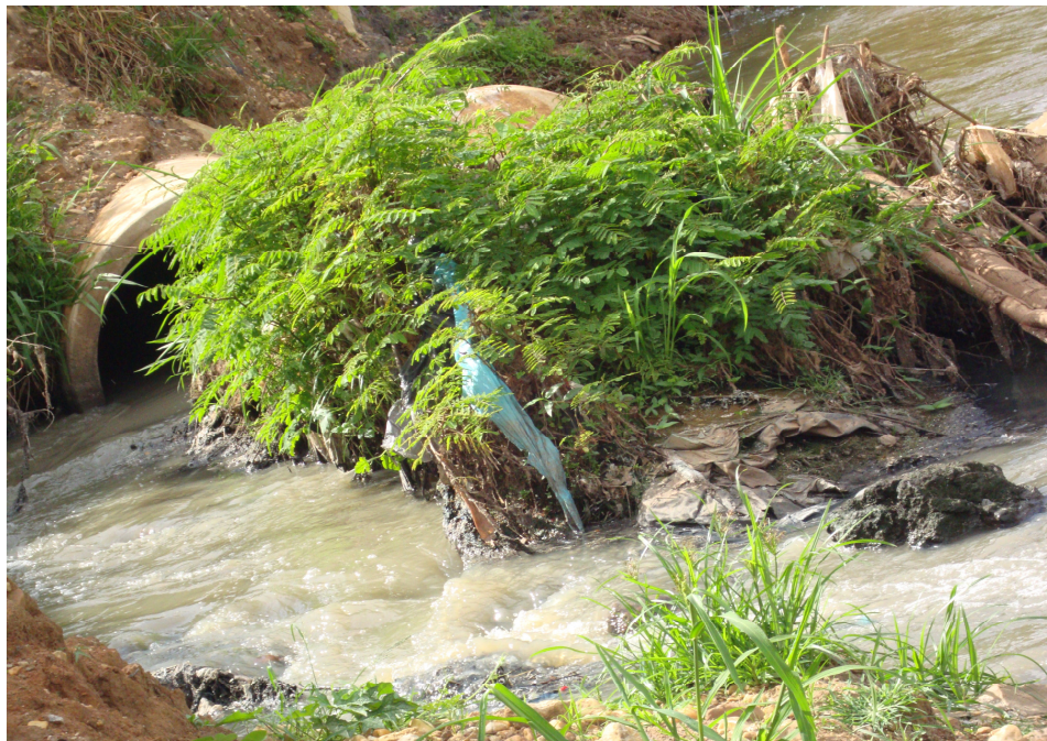
Figura 7. Acúmulo de lixo e escoamento de esgoto nas margens do Ribeirão Anicuns/Rio Meia Ponte, Setor São José, Goiânia/GO, (2009). Foto: Dinamara T. Versan, Nov/2009.
