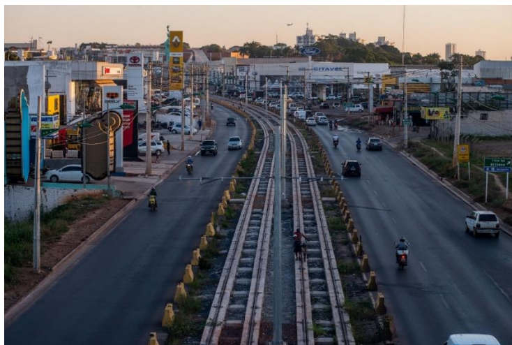
Quadro 3 – Fotografias de sobre o estágio atual das obras da Copa do Mundo de 2014 em Cuiabá. Fonte: Google Imagens, 2016.
