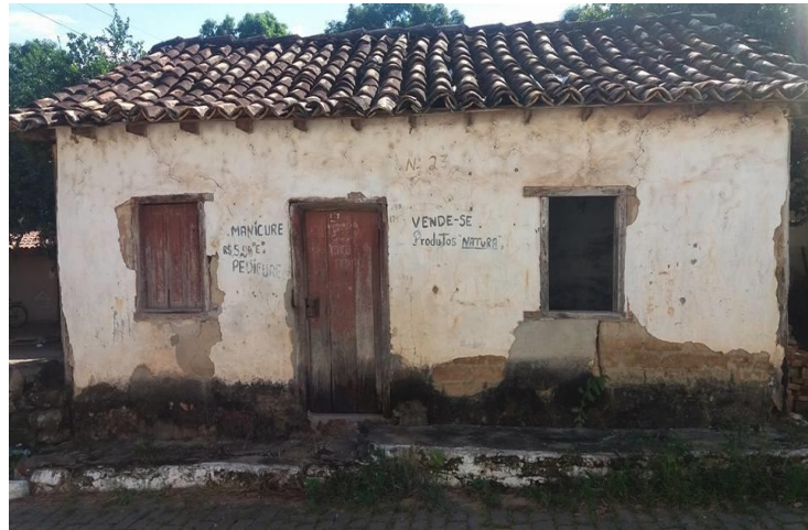
Figura 33 - Imagem de casa abandonada na Rua do Milagre Fonte: Autora - acervo pessoal.
