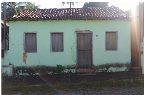
Figura 35 - Imagem de casa abandonada na Rua do Milagre Fonte: Autora - acervo pessoal.
