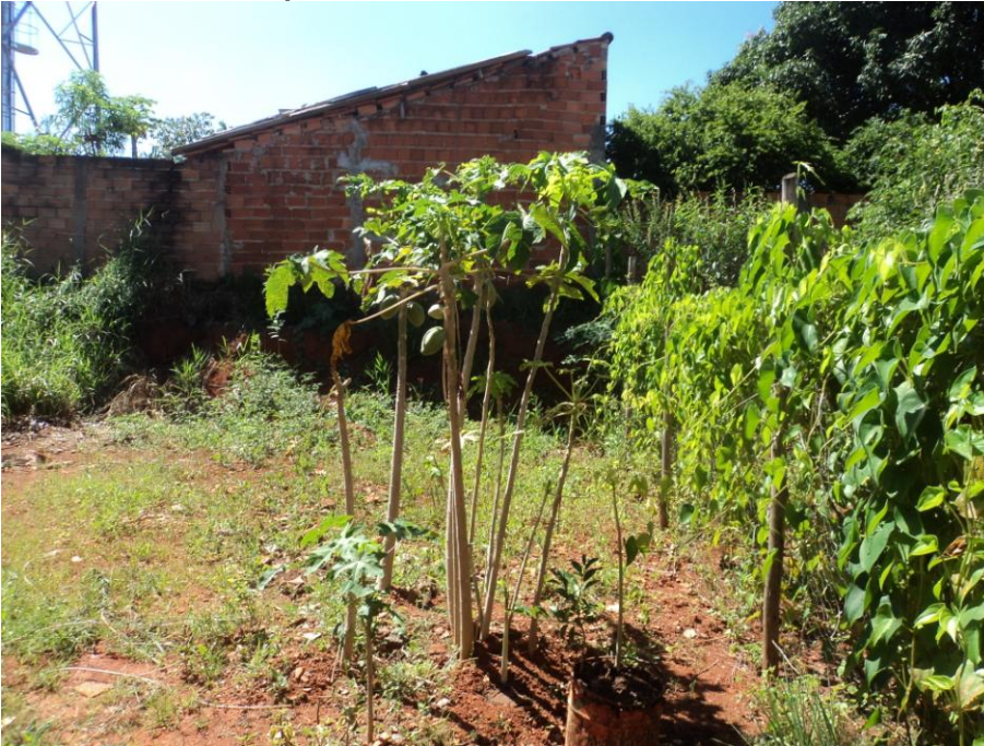
FOTO 3 - Fundo do quintal - Falta muro de arrimo - Eldorado Oeste IV.
