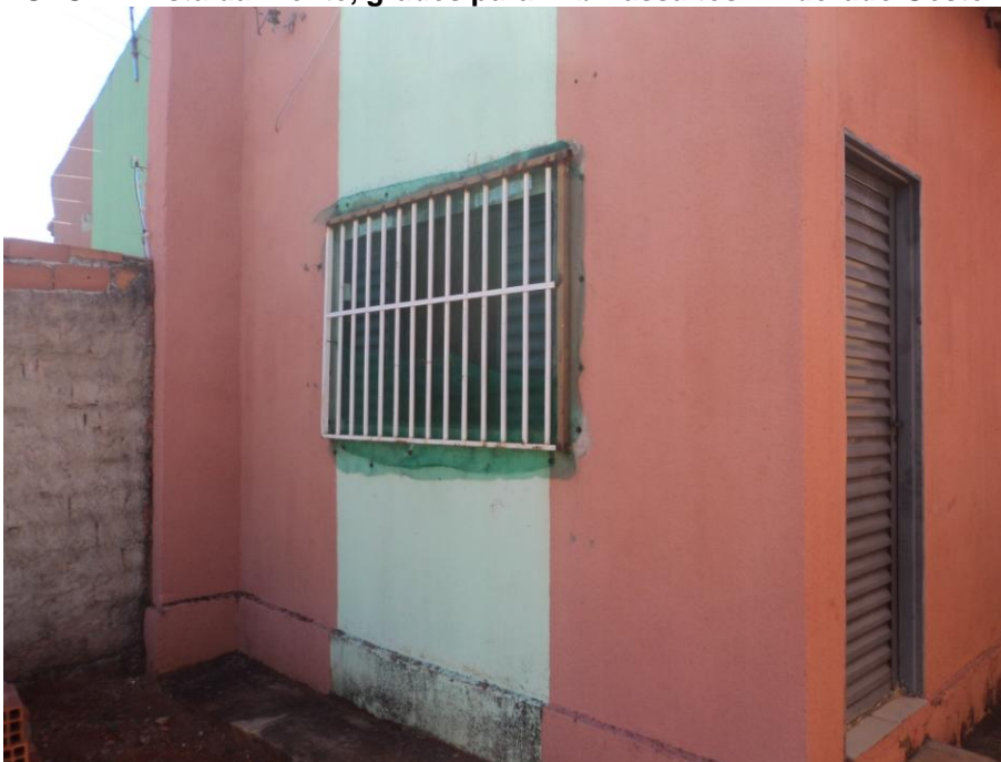
FOTO 4 - Vista da Frente, grades para inibir assaltos - Eldorado Oeste IV.
