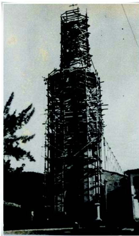
Figura 29: Construção da torre da Igreja de Nossa Senhora do Rosário em 1943 Nota: foto do acervo pessoal de Elder Camargo de Passos.
