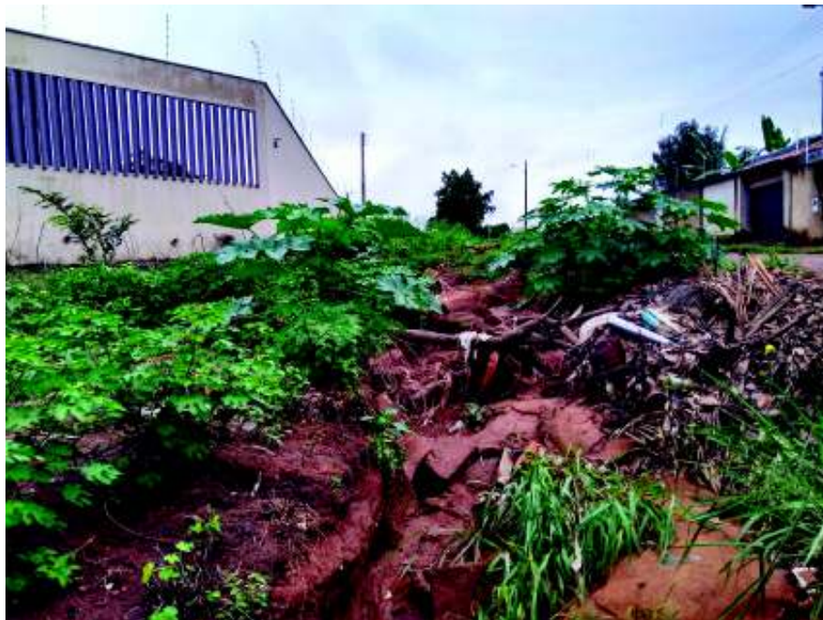
Figura 29: Situação do P-9, ausência de infraestrutura. Erosão aberta em via pública. (Janeiro 2018)
