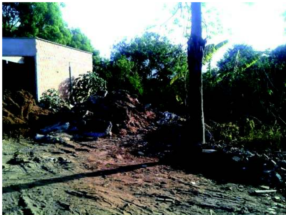
Figura 26: Situação do P-8, casa sendo edificada as margens do córrego Baixa Funda, período de estiagem. Fonte: Luana Barbosa (2017).
