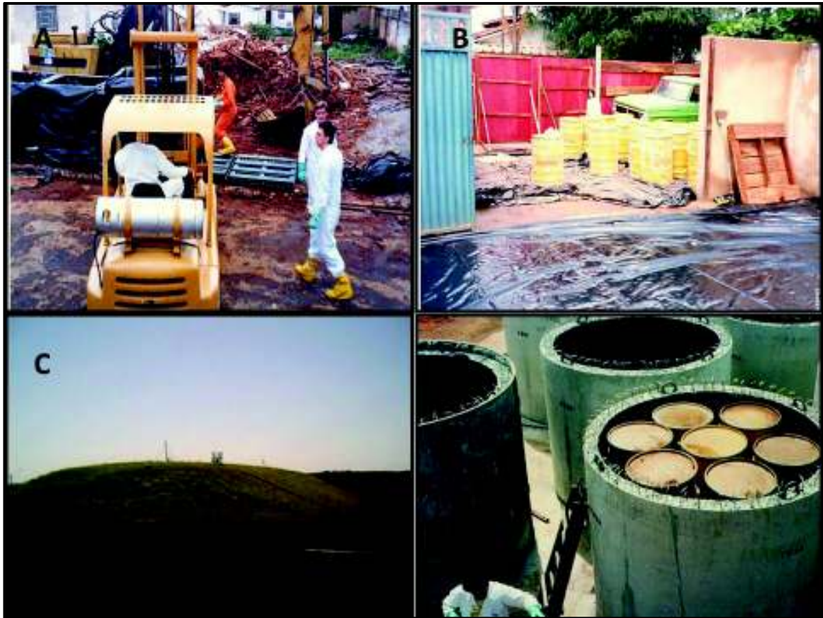
Figura 5. Imagem da descontaminação do local do acidente e do armazenamento do lixo radioativo. A: Retroscavadeira demolindo o pavimento contaminado com Césio-137 da Rua 57. B: Resíduo radioativo armazenado em contêineres. C: Área de armazenamento dos resíduos radioativos em Abadia de Goiás (Brasil). D: Acondicionamento dos contêineres metálicos com resíduos radioativos em plataformas de concreto. Fonte: C.A.R.A.
