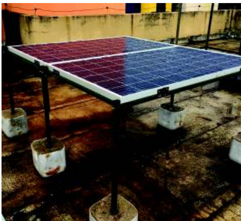
Figura 25 – Novo gerador fotovoltaico da PUC GOIÁS.
