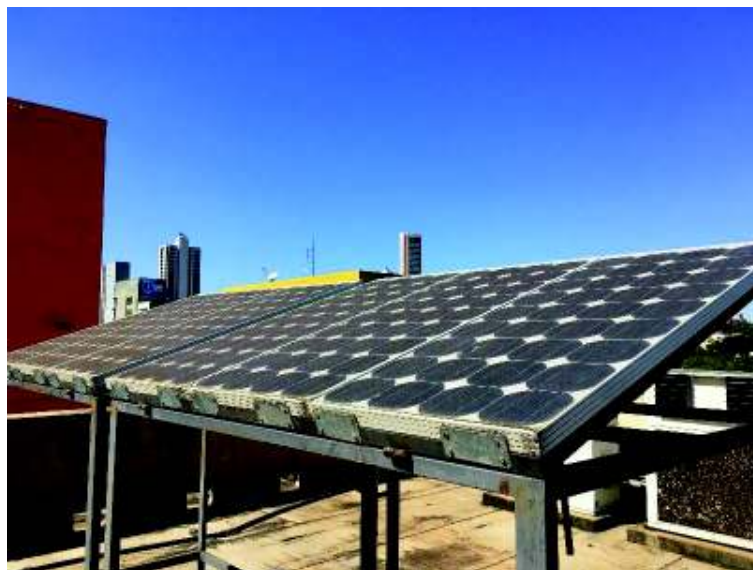
Figura 18 – Gerador fotovoltaico da PUC GOIÁS.
