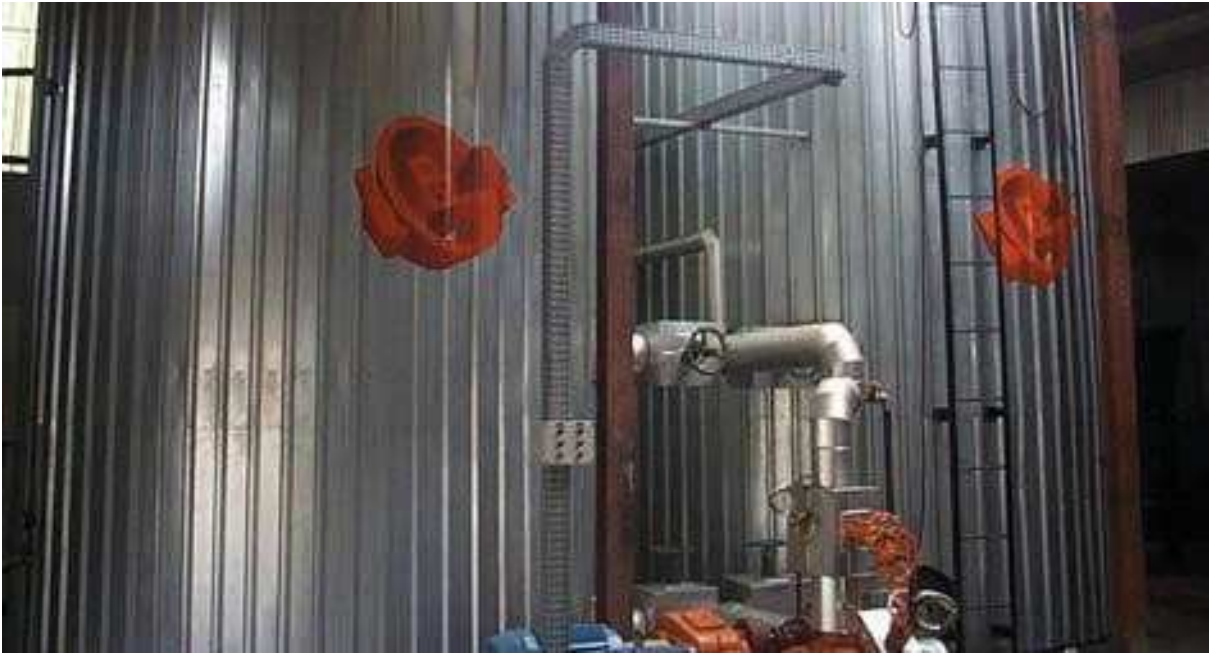
Figura 9: A incorporação da borracha ao asfalto é realizada em reatores que promovem a modificação química e física do ligante.
