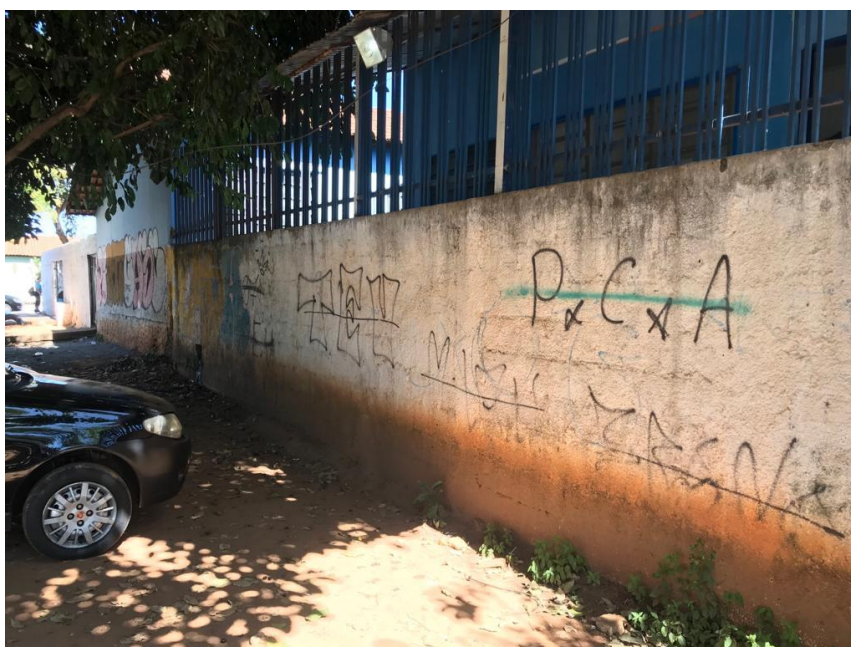
Imagem 03 – Siglas e desenhos no muro da Escola Nelson Rodrigues
