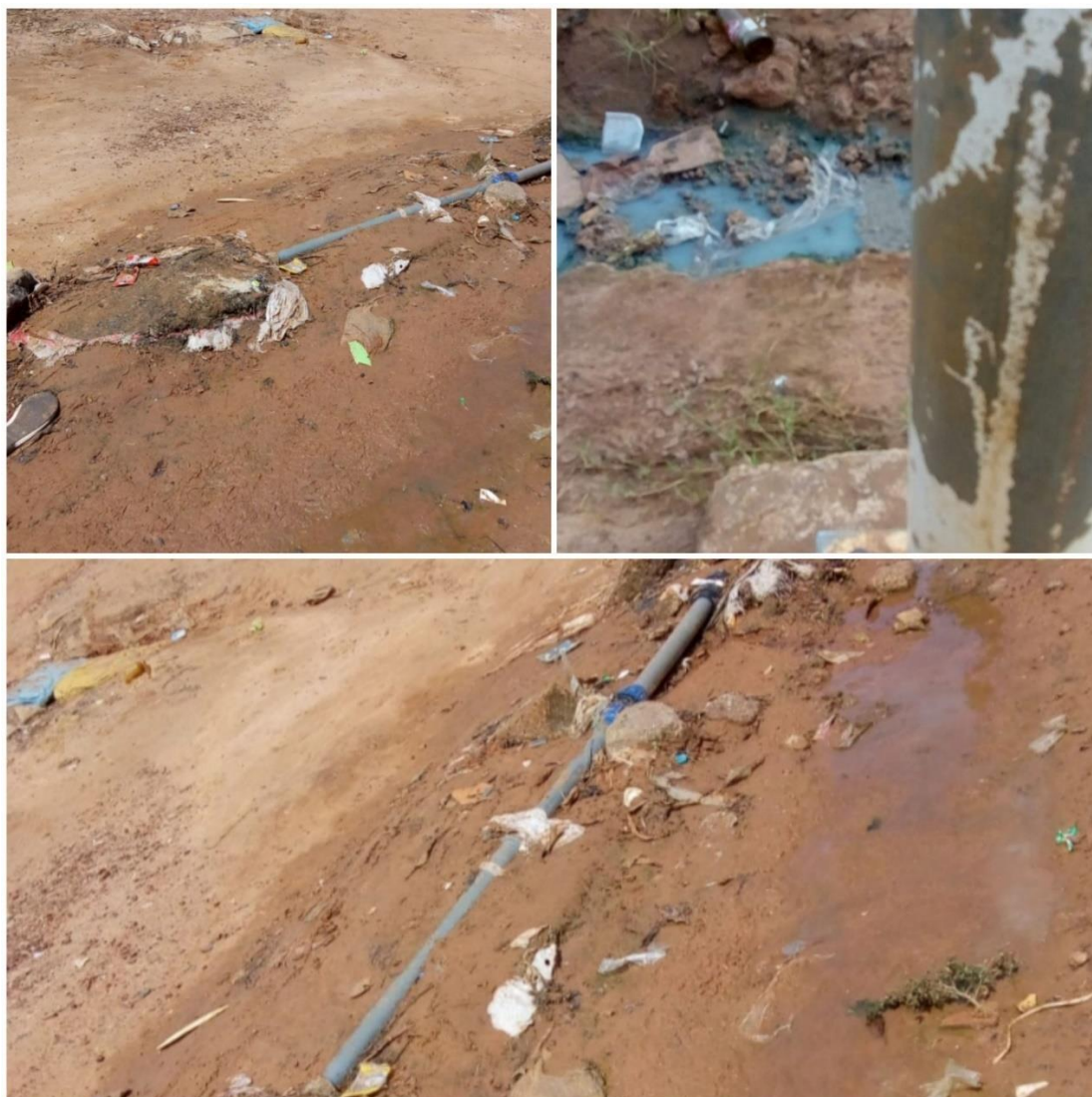
Figura 2 – Imagens capturadas das condições de tubulações de água nos domicílios do bairro Cuntum Madina, Bissau, Guiné-Bissau, África, 2019.
