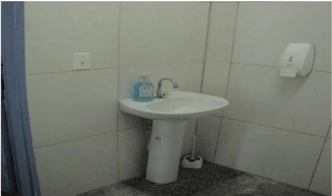
Figura 23 – Colégio Estadual Marcondes de Godoy – Pia do sanitário – PcD
